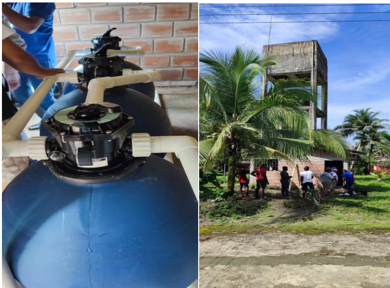
Foto 7: Sistema de Bombeo.
