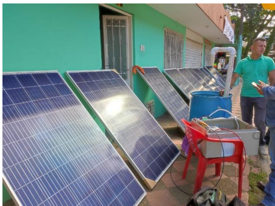
Foto 3: Suministros paneles solares
