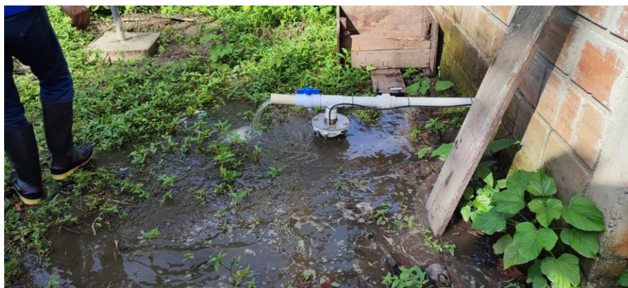
Foto 1: Mantenimiento y desinfección de pozo profundo
