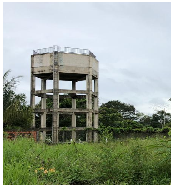
Tanque almacenamiento Planta tratamiento
