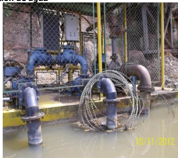
Equipo de bombeo
