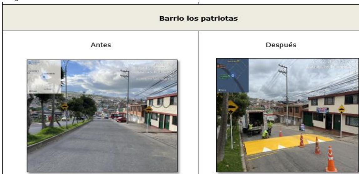
Imagen 83 Reductores de velocidad instalados en la red vial
