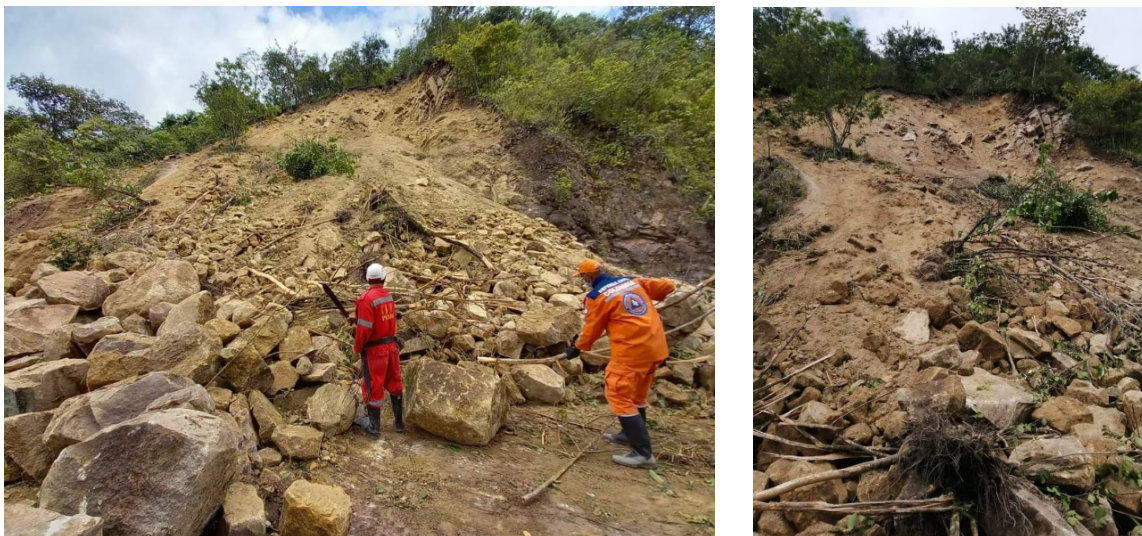
Imagen. Deslizamiento Tomogó - cascada junio de 2021
