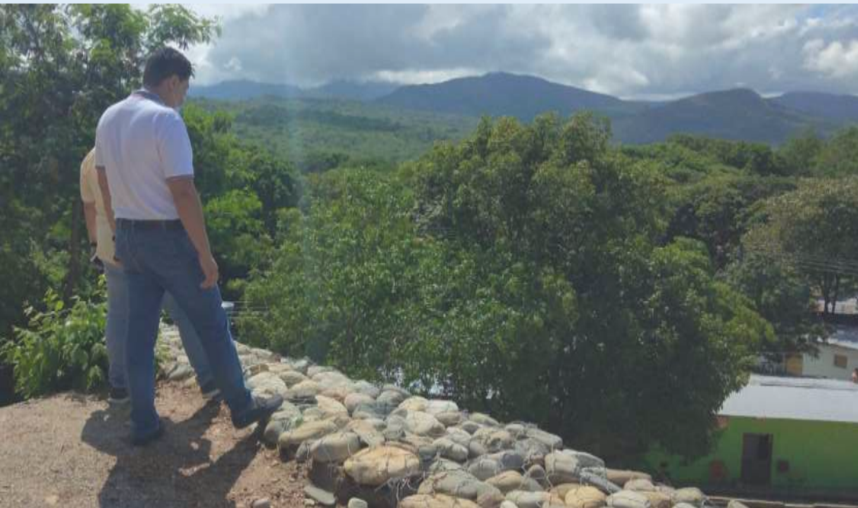
Gaviones en piedra en el barrio San Martin II Etapa, con el fin de proteger a la población del deslizamiento de material sobre viviendas en la ola invernal
