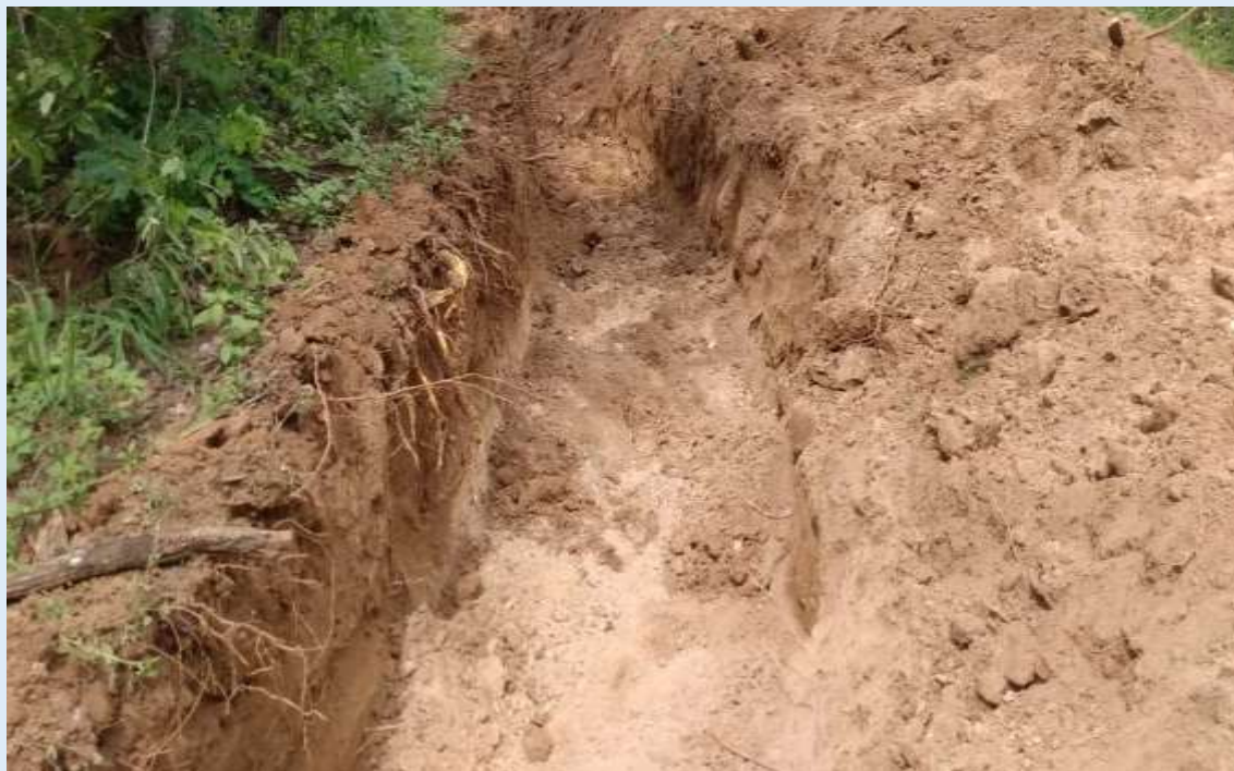
Se removió material que cayó sobre las veredas Naranjales y Laureles
