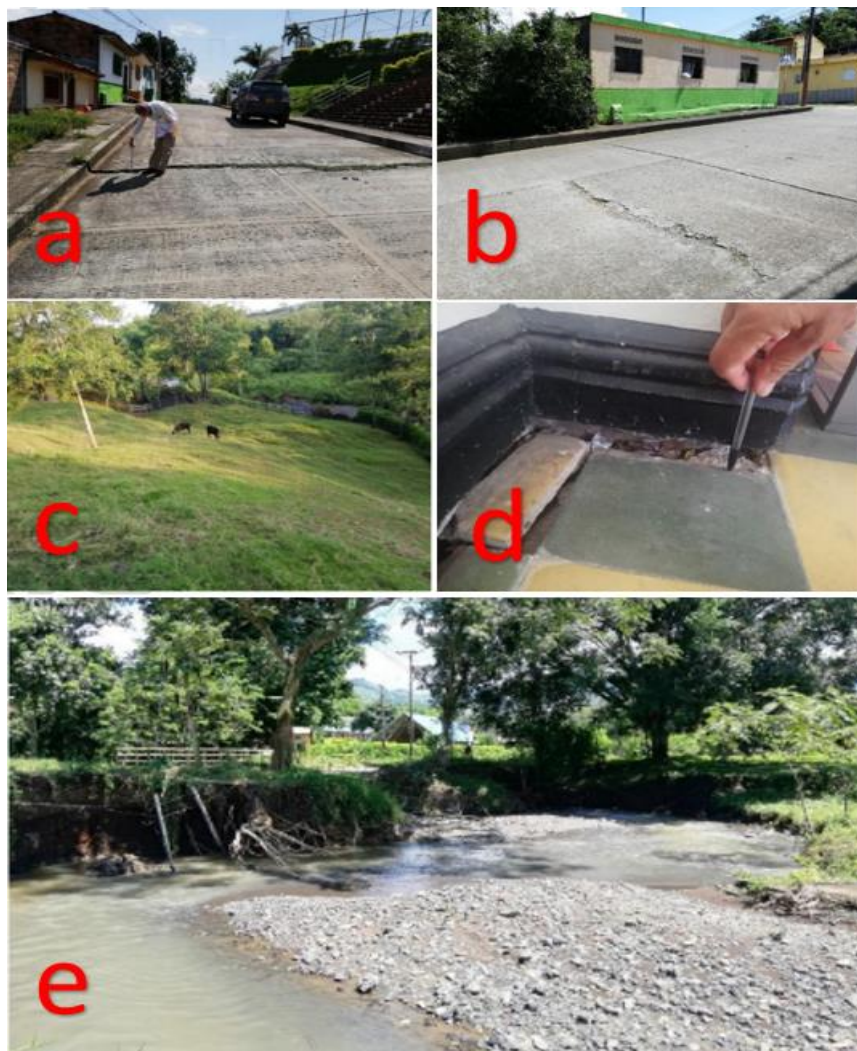
a) Grietas en la vía Palatino. b) Agrietamientos en la Calle 7 con Carrera 4, cerca al Alto Palatino. c) Talud del Barrio 7 de Agosto, cercanía a la quebrada Limones. d) Agrietamientos en el Colegio La Milagrosa. e) Socavación lateral de la Quebrada Limones.
