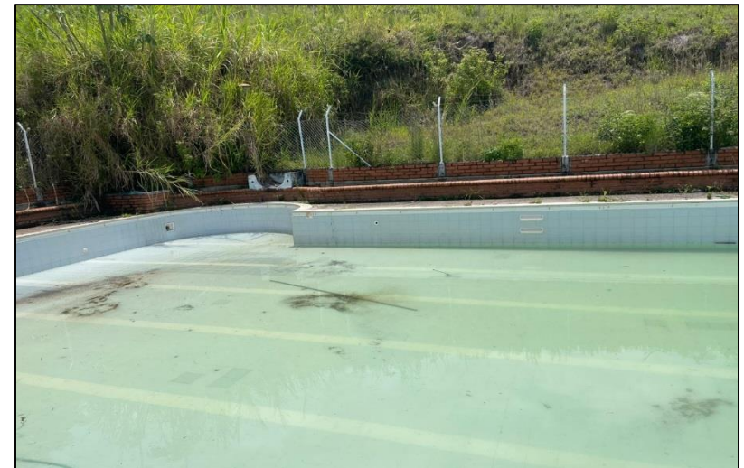
Imagen 2. Estado Piscina Municipal Florencia Cauca.
