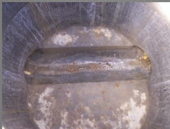
Cámara de inspección.
