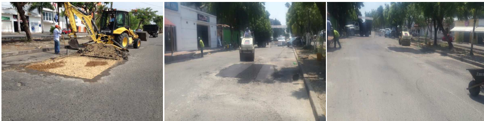
PAVIMENTACION EN EL BARRIO PRIMERO DE ENERO ENTRE LAS MANZANAS 1-3-4- Y EL BARRIO GIRASOL
