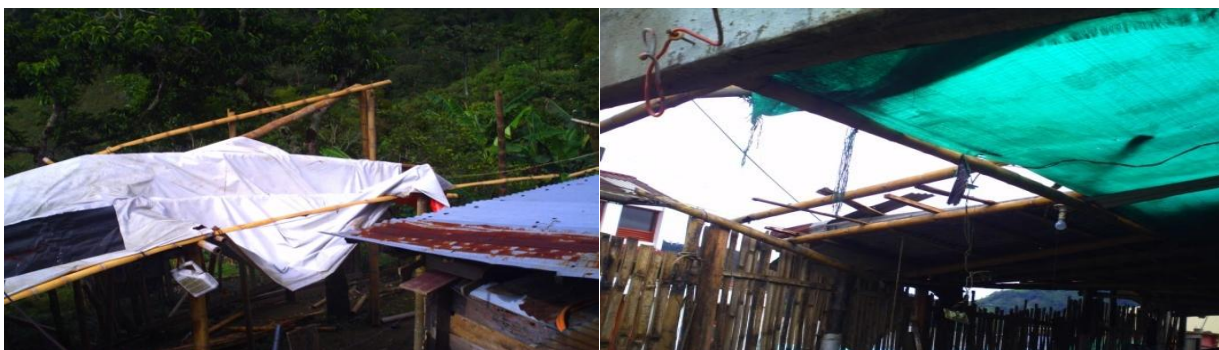
Construcciones urbanas afectadas por la ola invernal (tormenta del 05/04/2012).
