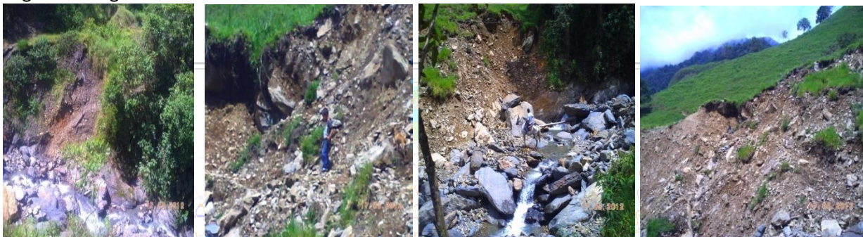
Registro fotográfico vereda Santa Helena. Estado de la trocha carretable cerca a la escuela. 7
