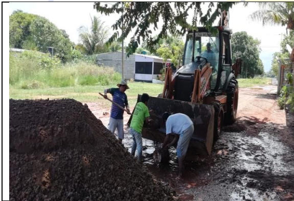
10 Kilómetros de vías deterioradas
