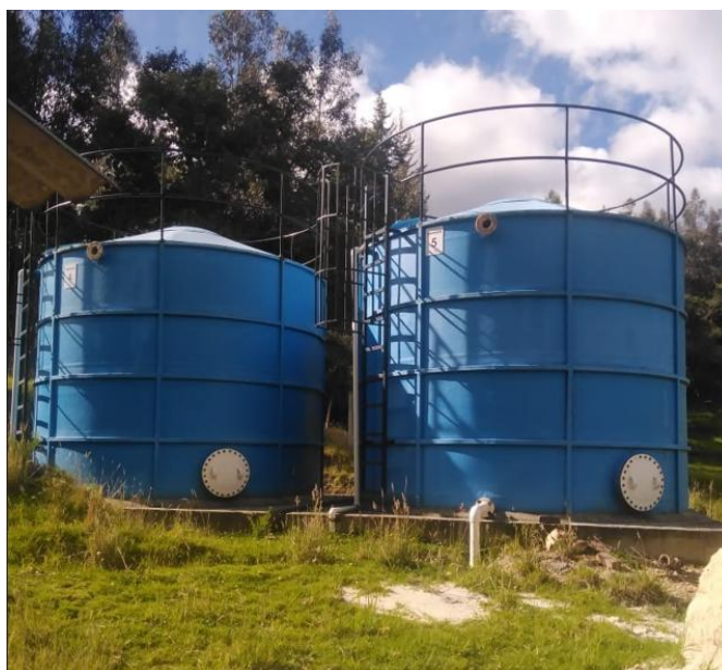
Figura 7. Captación de agua del acueducto rural de la vereda La Independencia
