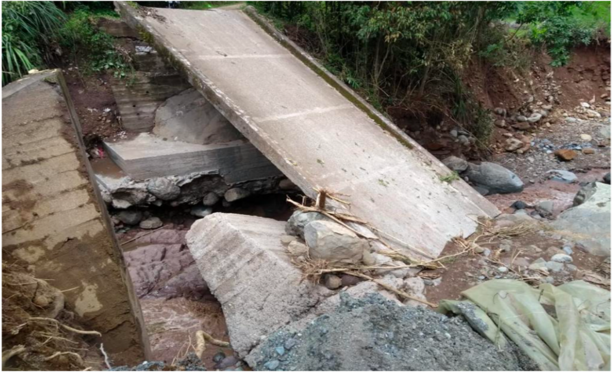
Imagen 12 Puente afectado en el K5+600 vía “Supía – La Quinta – La Amalia”
