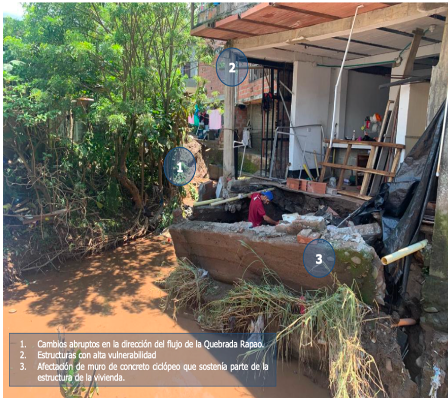
Imagen 16 Afectación de muro posterior en vivienda Barrio Popular - Asentamientos irregulares con estructuras deficientes en el interior de la faja de retiro de la quebrada Rapao
