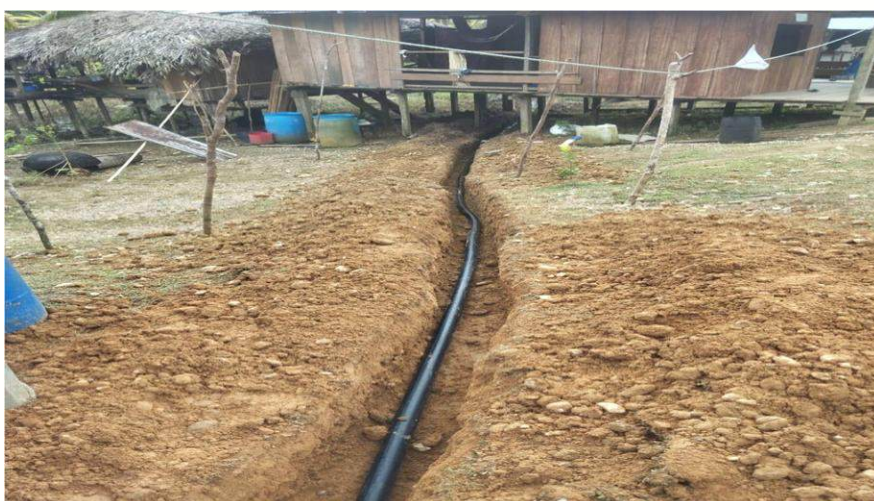
Red de Distribución y casas aguateras
