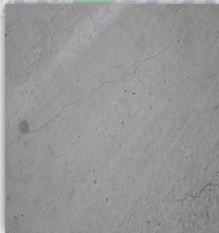
Figura 175: Agrietamiento en las placas de las canchas.
