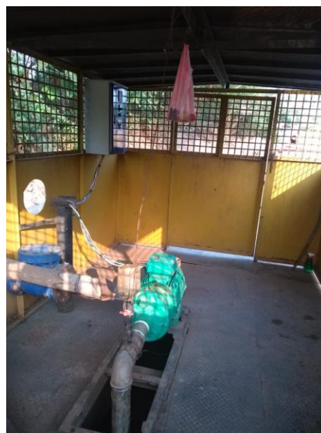
Punto de captación
