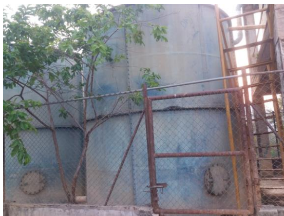
Tanque de Almacenamiento Playitas
