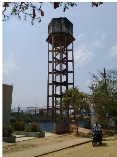
Tanque Elevado de la cabecera Municipal
