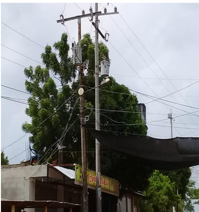
Redes de distribución eléctrica en la, Cabecera municipal.
