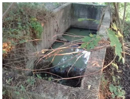
Zona de descarga de aguas servidas
