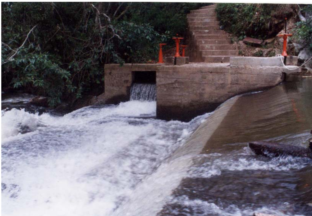
----- Fotografía No. 16 – Sistema de Captación
