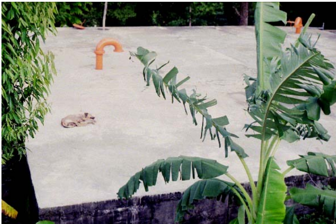
----- Fotografía No. 10. Tanque de almacenamiento.
