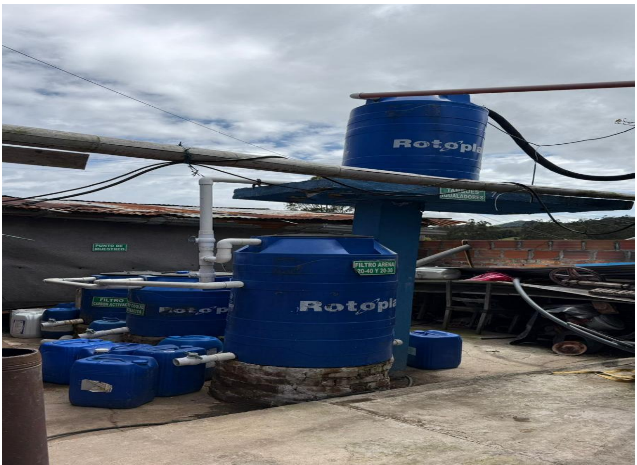
Ilustración 4 Planta de tratamiento de aguas residuales curtiembre 1
