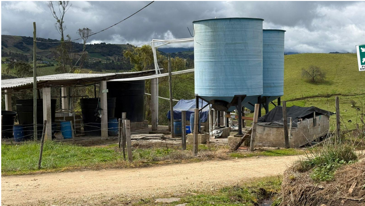
Ilustración 7 Planta de tratamiento de aguas residuales curtiembre n°2
