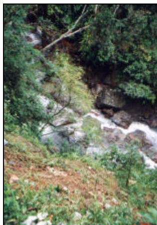
Socavación de la quebrada Negra sobre el Talud de la escuela del Centro Poblado de La Montaña
