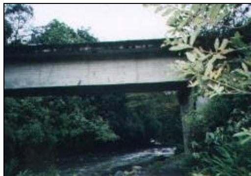
Puente sobre la carretera que de Camancha comunica con el municipio de Muzo (Boyacá), el cual requiere reparación de sus bases.
