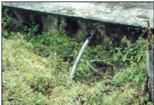
Conducción del agua desde el tanque de captación hasta las viviendas.
