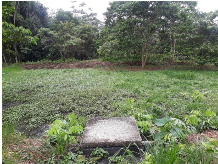
Ilustración 32 Caja de distribución campo de infiltración.
