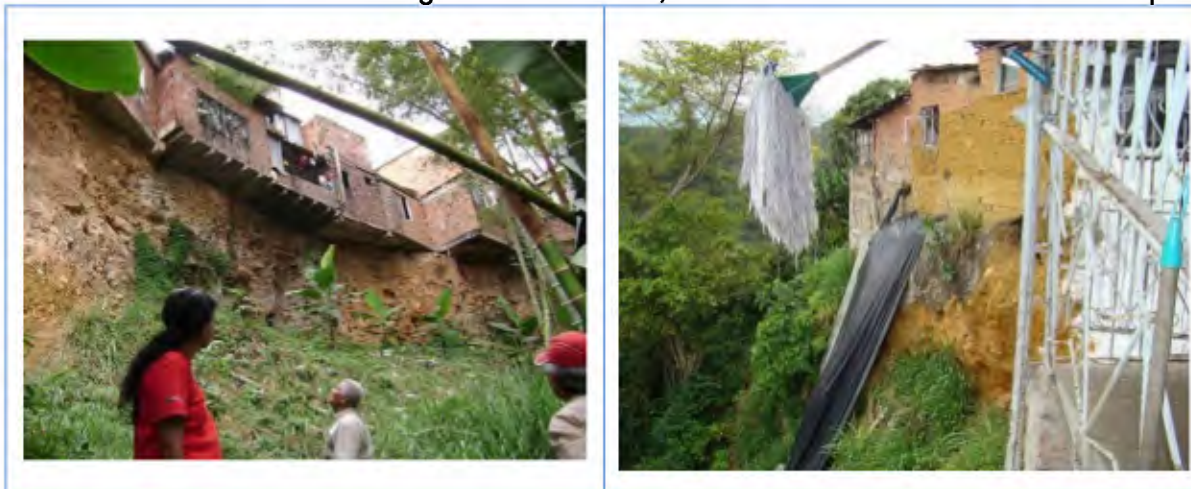
Gráfica N° 99. Casas en alto grado de deterioro, construidas sobre el borde del escarpe
