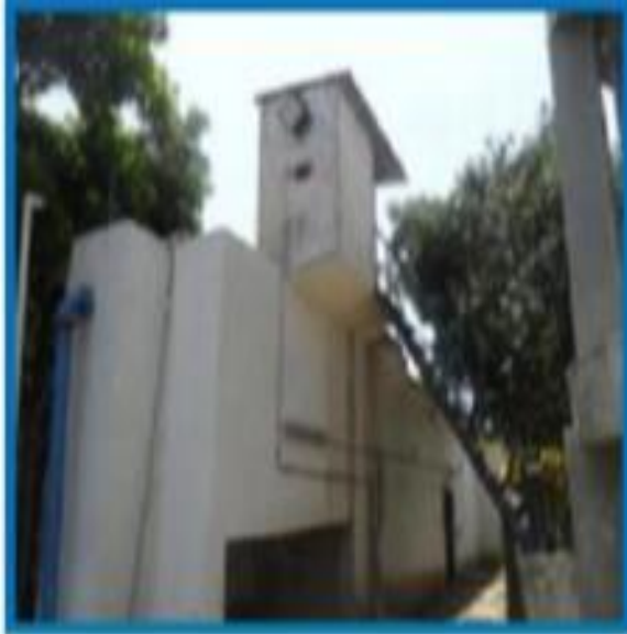
Planta de Tratamiento Guáimaro
