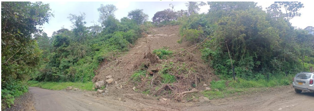
Ilustración 55. Zonas de riesgo por Movimientos en Masa
