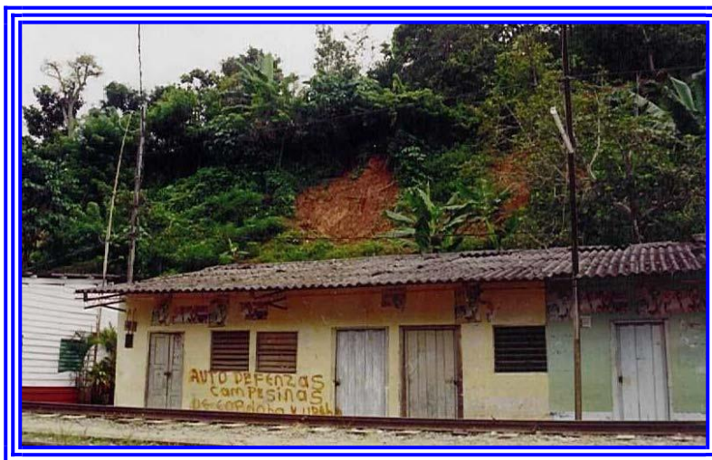
Foto 48. Viviendas en alto riesgo a un costado del cerro Chipre.
