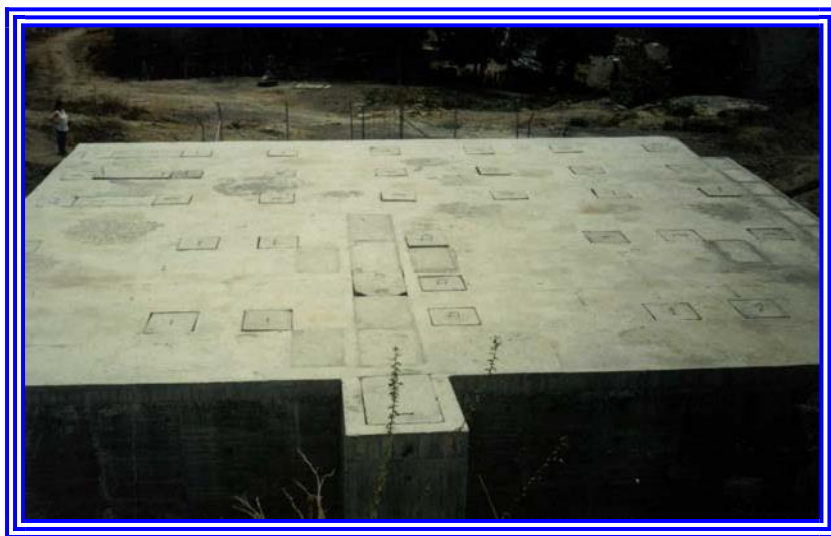
Foto 76. Planta de Tratamiento en el Sector La Malena sin funcionar.
