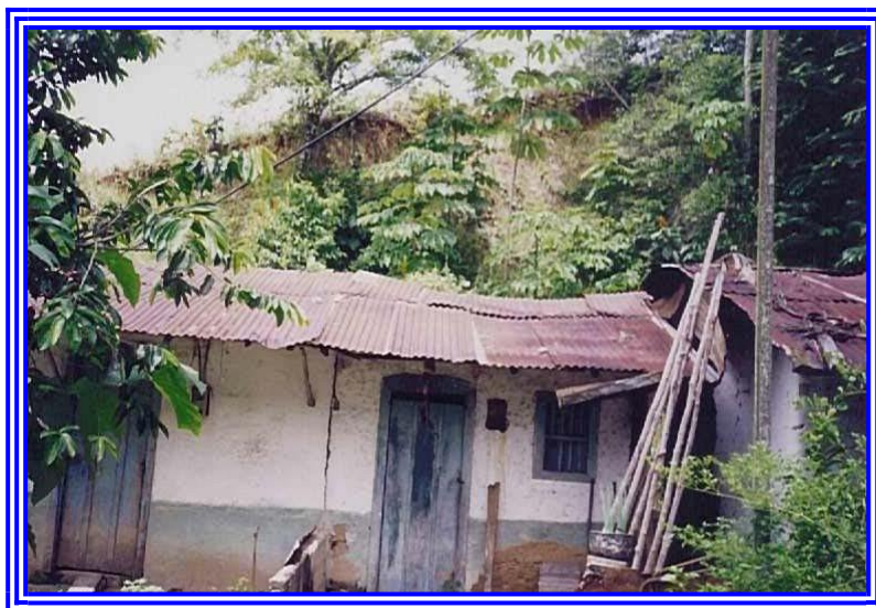
Foto 45. Casa ubicada en la parte baja del cerro San Martín en alto riesgo por el talud vertical
