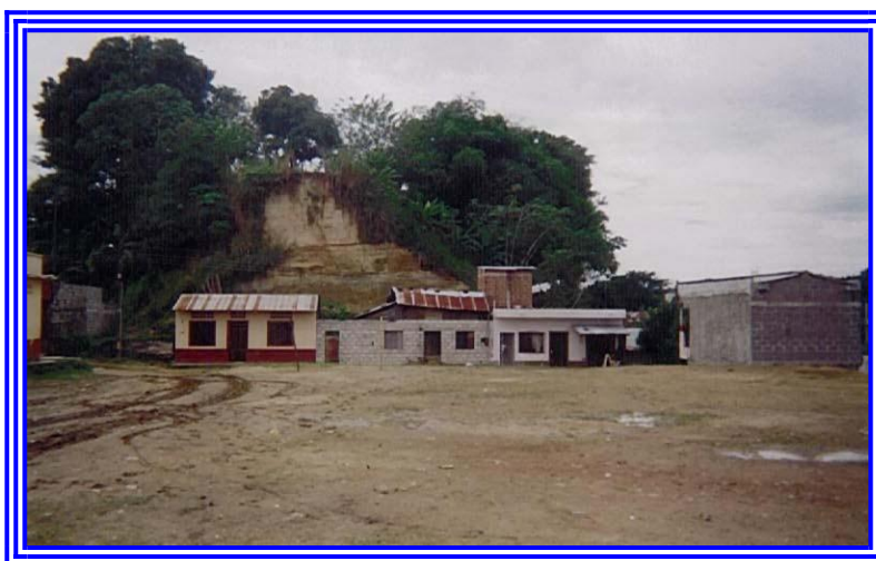
Foto 47: Viviendas en alto riesgo por movimiento en masa en el Cerro San Martín
