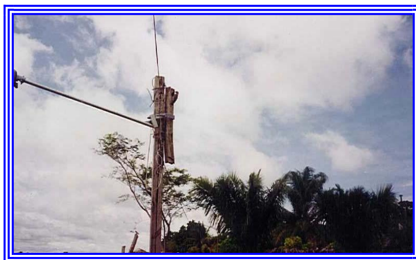
Foto 82. Alumbrado público en Puerto Murillo en malas condiciones.
