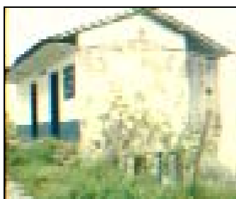
Mal estado de las Viviendas
