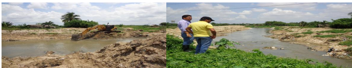
Fotos de trabajos de adecuación hidráulica del arroyo el platanal realizado por el consorcio costa Caribe 2013.
