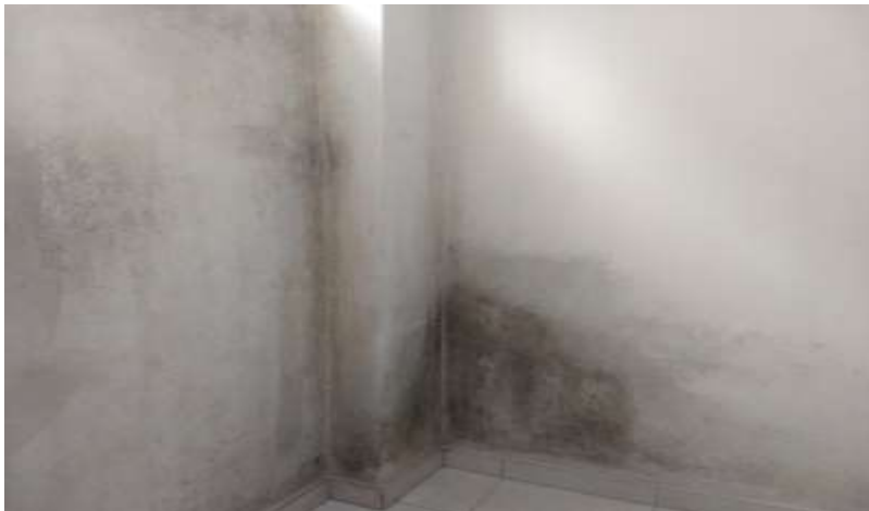
Zona urbana: Carrera 4 calle 6 Perturbación en vivienda por daños en el alcantarillado del vecino
