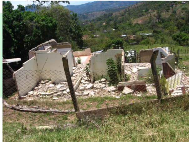
Fotografía No. 2 Vivienda Averiada.
