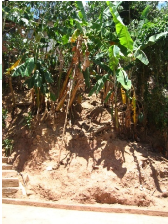
Fotografía No. 1 Deslizamiento.
