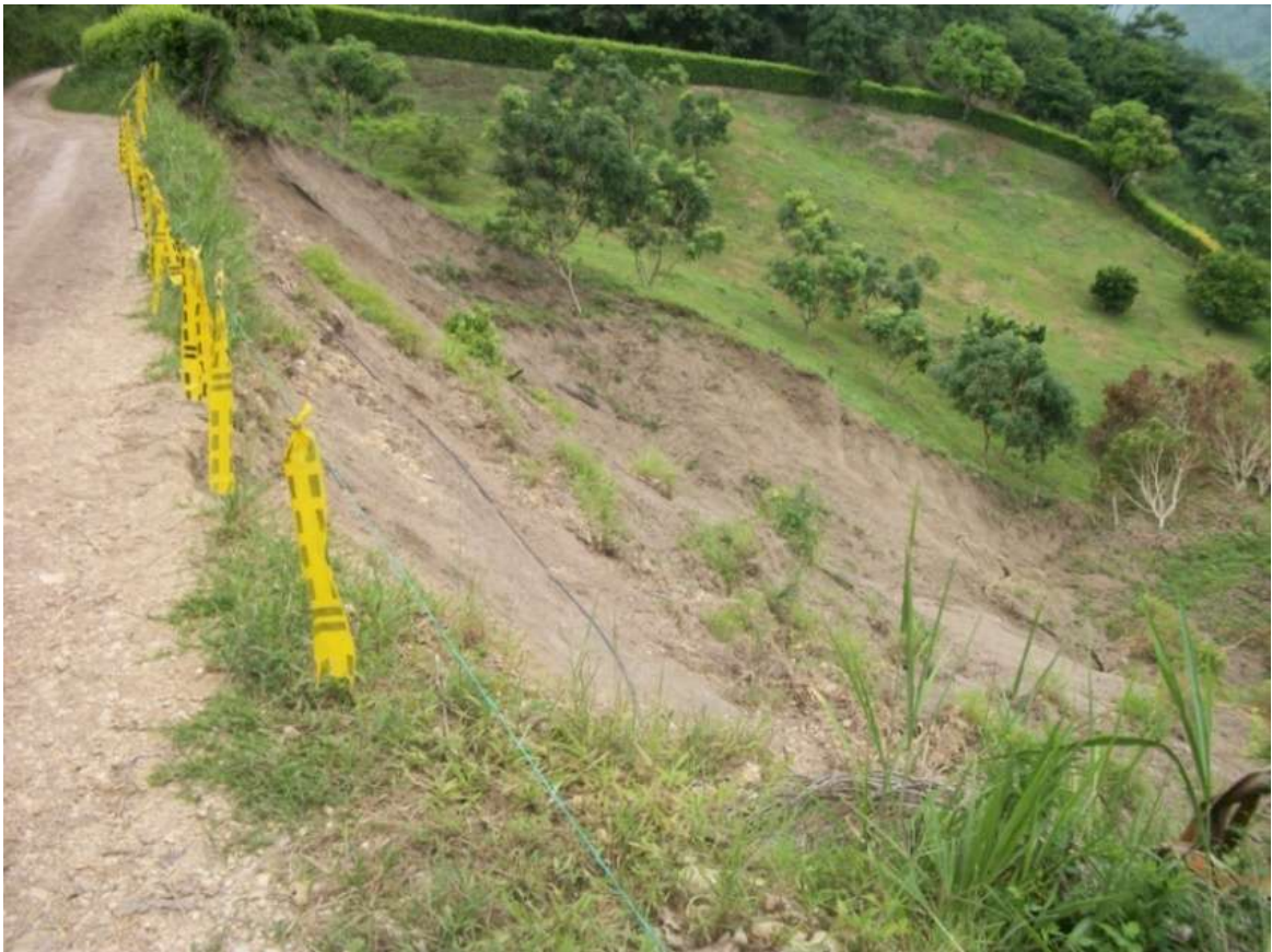
Deslizamiento Vda las Mercedes – Marzo 2010
