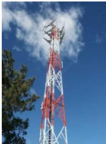
Imagen 3. Torre de Telefonía
