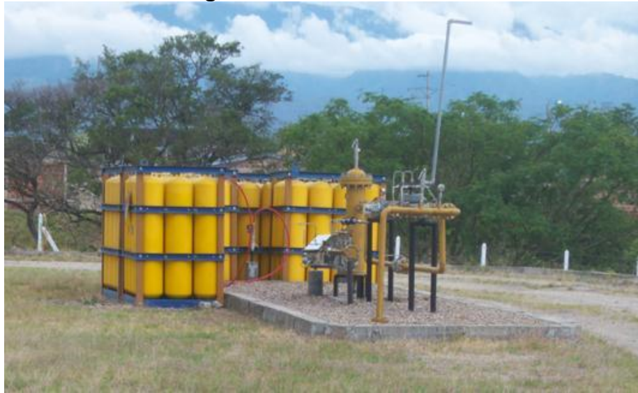
Imagen No.1 Cobertura de Gas
