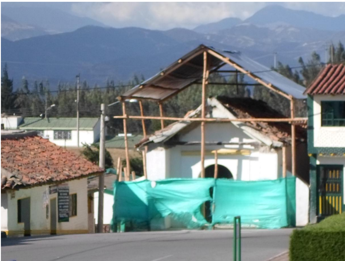
REALIZACION DE LOS ESTUDIOS TECNICOS Y OBRAS DE RESTAURACION DE LA CAPILLA POSA DEL MUNICIPIO DE TOPAGA
