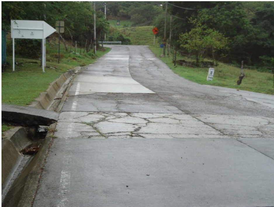
Foto 32: Una muestra del deterioro en varios tramos de la Avenida Circunvalar
