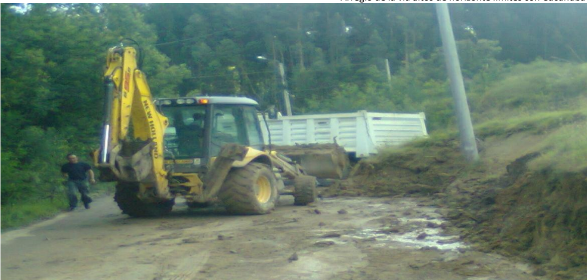
Derrumbe sitio Quintiliano Gómez
