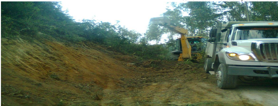
Deslizamiento de tierra
