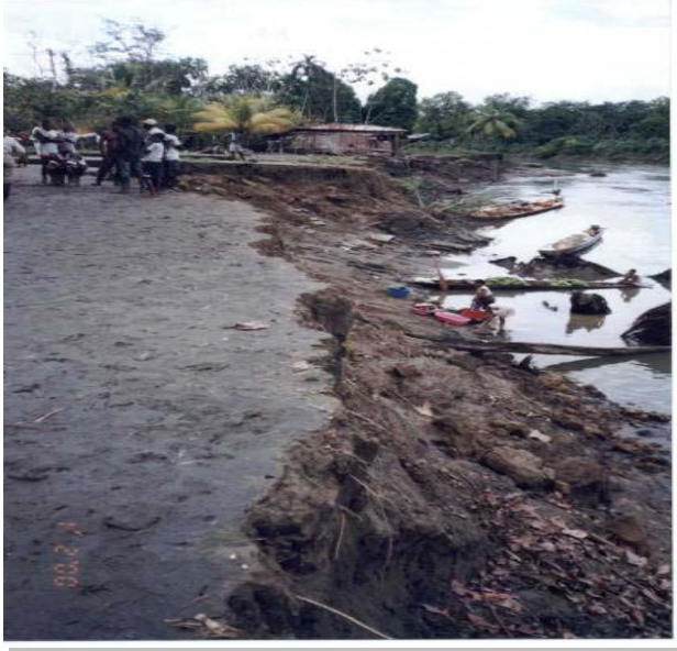
Foto. Erosión Puerto Medellín (Río Arquía)
