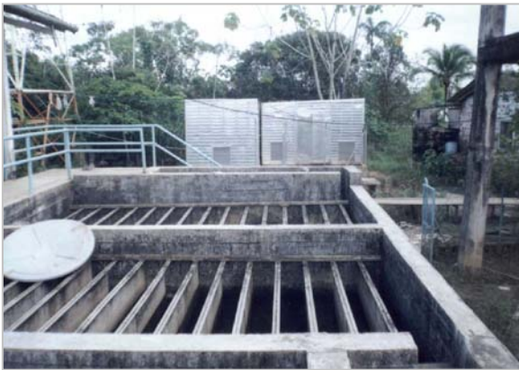
Foto. Planta acueducto (no se encuentra en funcionamiento) cabecera municipal Vigía del Fuerte
