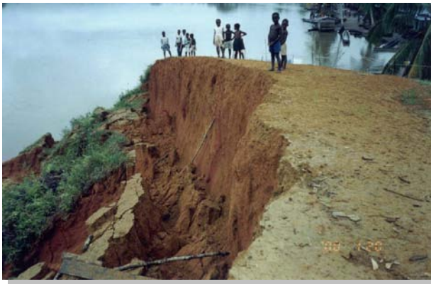
Foto. Erosión Vereda San Miguel (río Atrato)
