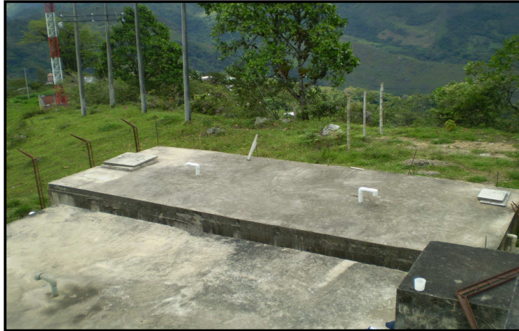
Tanque de almacenamiento No. 2.
