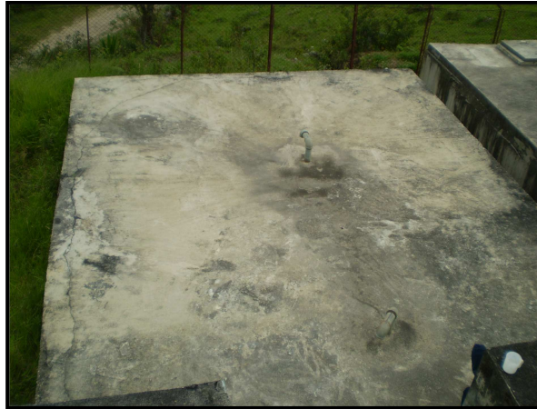
Tanque de almacenamiento No. 1.
