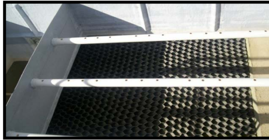
Figura 5. Sedimentador y filtros
