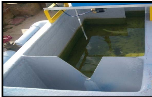
Figura 4. Zona de mezcla rápida
