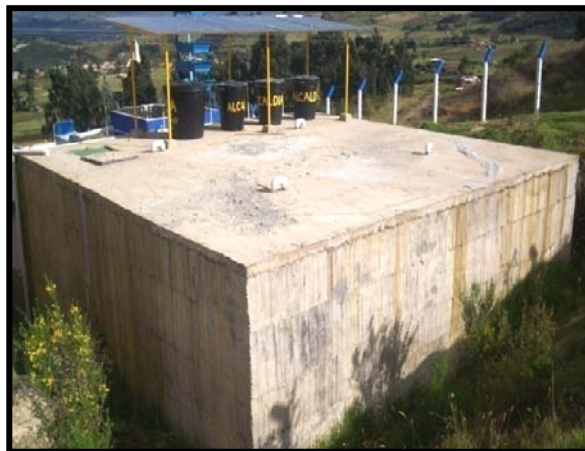
Figura 6. Tanque de almacenamiento para distribución de agua
