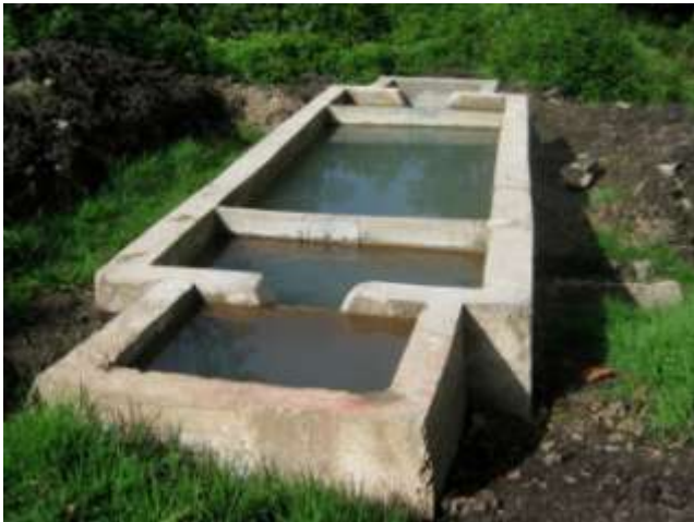
Desarenador para el Acueducto del Casco Urbano. Ubicado Vereda en la Vereda Pijaos.
