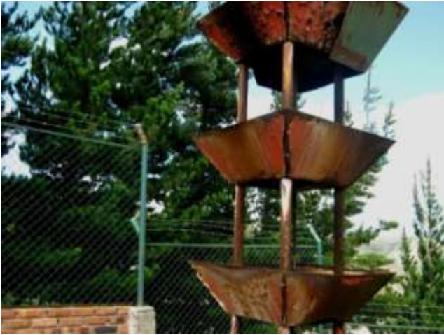
Torre de aireación Planta de Tratamiento El Llano antes del mantenimiento.
