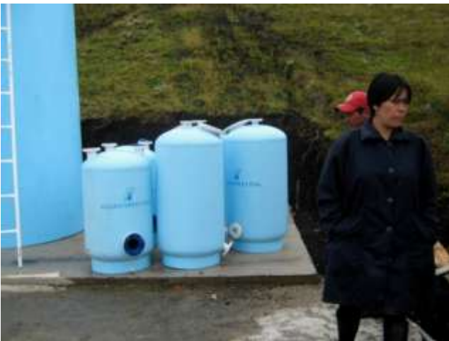
Planta de Tratamiento Vereda Chipacatá
