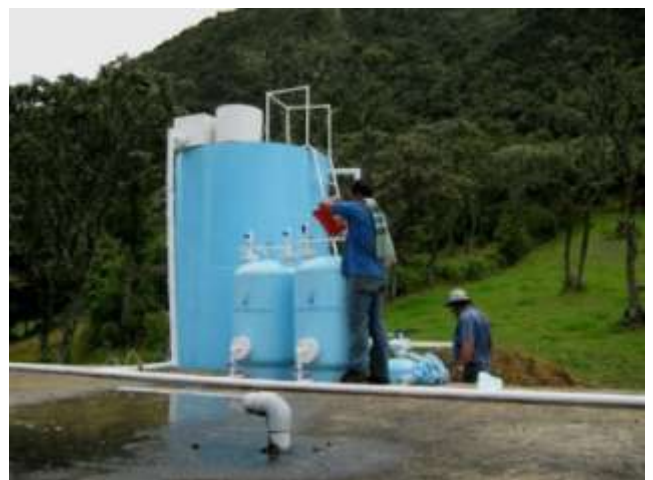
Planta de tratamiento Vereda Pijaos Parte Baja
