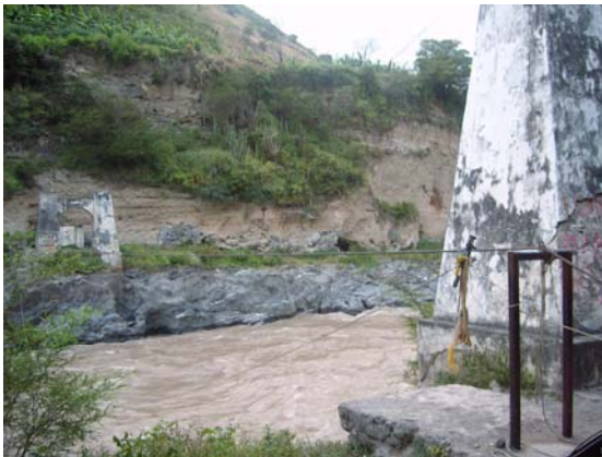
Puente intermunicipal derribado entre Policarpa y Cumbitara
