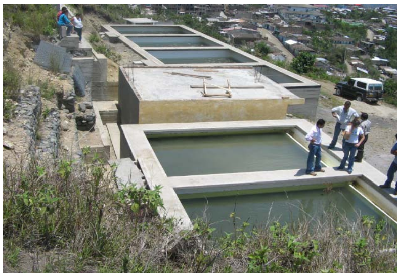
Planta de tratamiento de agua potable – Policarpa
