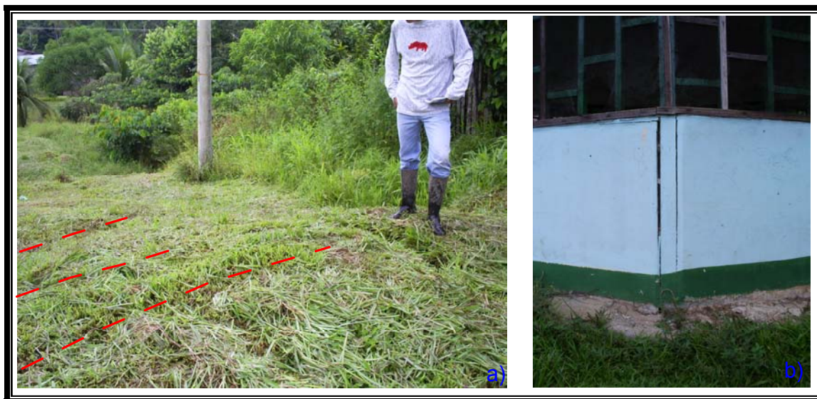
Figura 38 a) Grietas de tensión en suelos arcillosos hacia la parte sur del INEAGRO sección "A". b) degradación estructural en una de las aulas INEAGRO sección "A".
