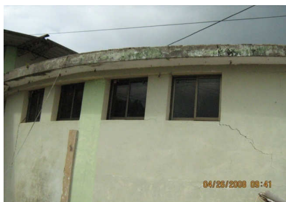
Figura 25. Hospital agrietado (zona inestable)
