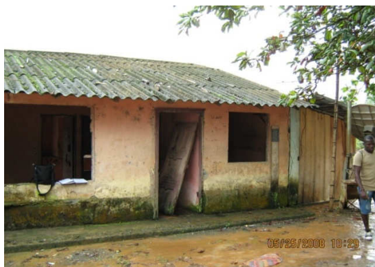
Figura 19. Puesto de salud zona rural en abandono
