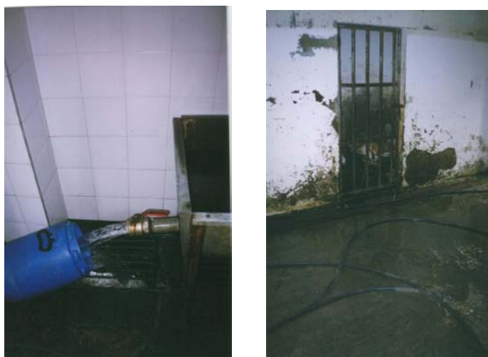
Foto No 36 Desperdicio de agua en el matadero municipal
