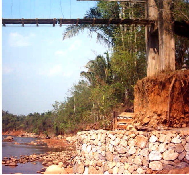
Puente Colgante que comunica a la vereda de Piedecuesta. La socavación amenaza su estabilidad, pequeña obra de contención se esta realizando actualmente aunque las dimensiones de los gaviones no son los mas adecuados para la solución.
