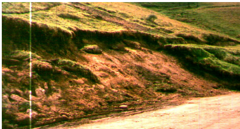
FIGURA No. 11. DESLIZAMINETOS DE TIERRA VIA PRINCIPAL
