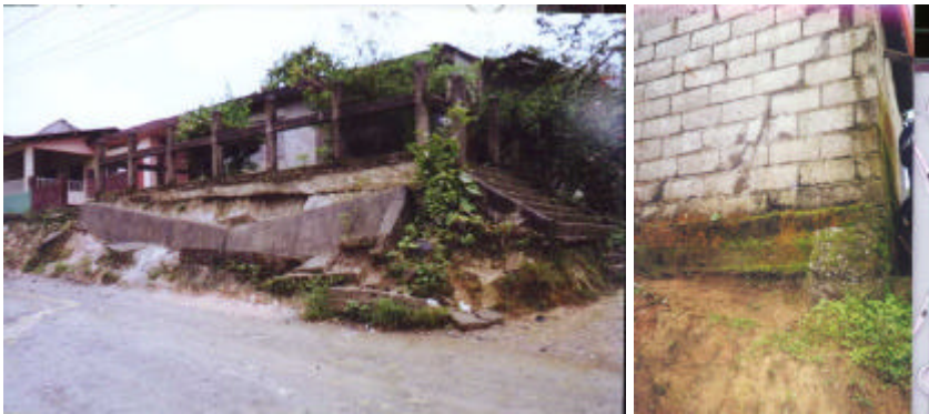
Construcciones sin las cimentaciones adecuadas y afectadas por erosión laminar
