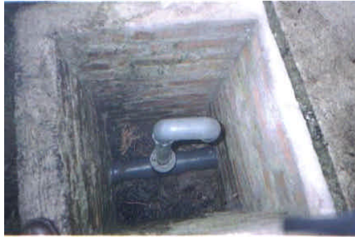
Foto, Ventosa línea de conducción quebrada La Maravilla
