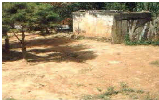
Foto: Tanque de almacenamiento sistema acueducto de algarrobo.
