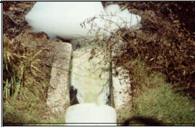
FOTOGRAFÍA No. 5 Aliviadero Ubicado en la Zona Lateral del Primer Modulo de la Laguna de Oxidación
