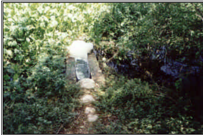
FOTOGRAFÍA No. 6 Efluente de la Laguna de Oxidación
