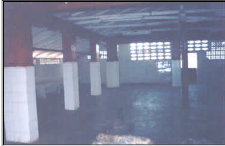
FOTOGRAFÍA No. 27. MATADERO MUNICIPAL NO CUENTA CON LAS MEDIDAS MÍNIMAS SANITARIAS
