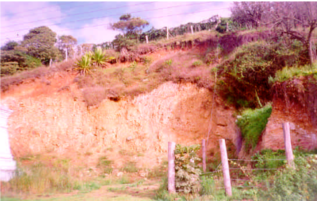
FOTOGRAFIA 1.11 Fotografía tomada desde el ángulo opuesto al anterior donde se observa claramente el movimiento de la masa rocosa hacia la vía.
