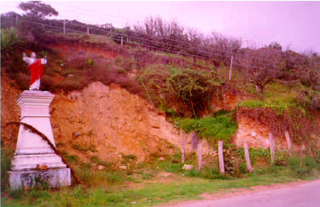
FOTOGRAFIA 1.10. Deslizamiento ubicado en el casco urbano, ha sido acelerado por la extracción de materiales de construcción del pasado. Nótese la grieta en la corona y el movimiento del material hacia la vía.
