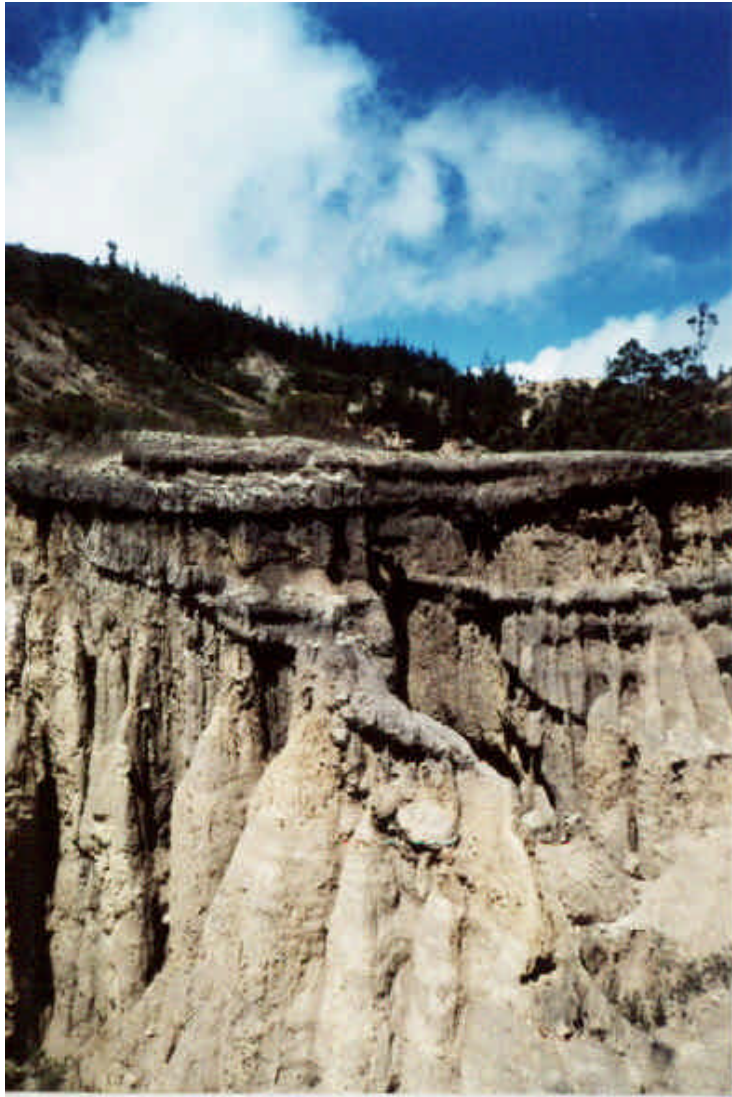
Fotografía 5. Algunos estoraques generados por erosión severa en rocas de la Formación Conejo (Kscn).
